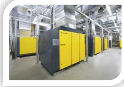
Druckluft, -verteilung, Wärmerückgewinnung
